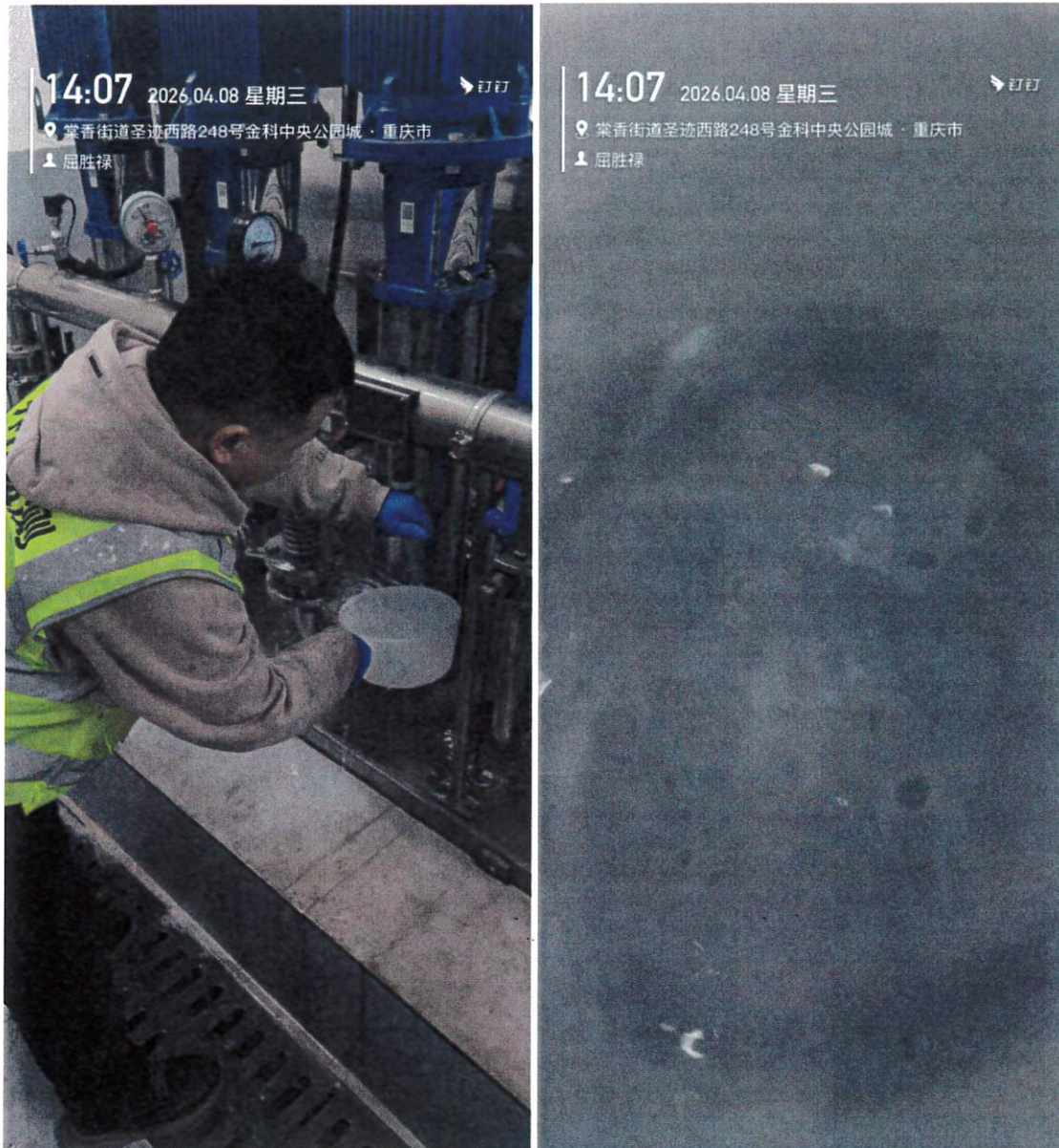
F2:铜锣湾二期负一楼水泵房
